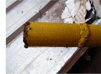
Özensiz kaynaklı boru kaynak yerinden kopmuş
